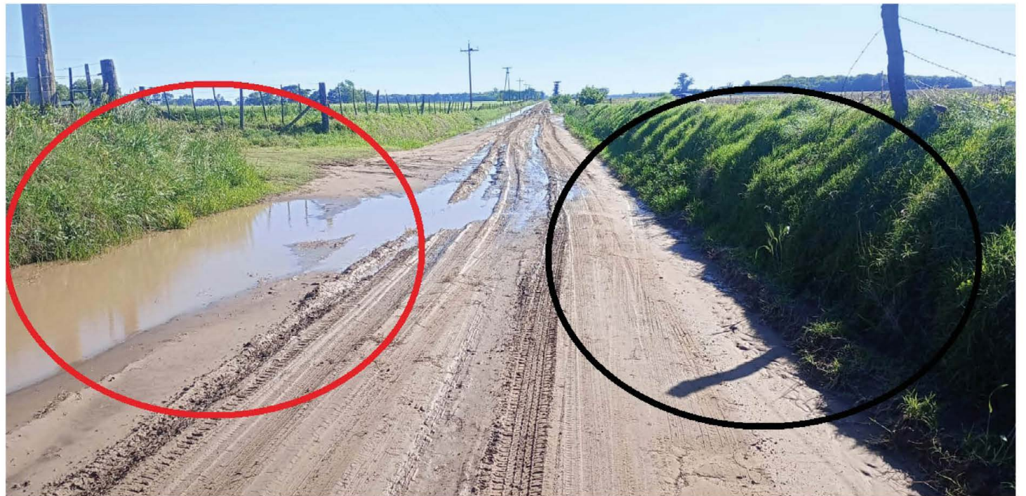
Cuneta poco profunda. Rasante baja.
