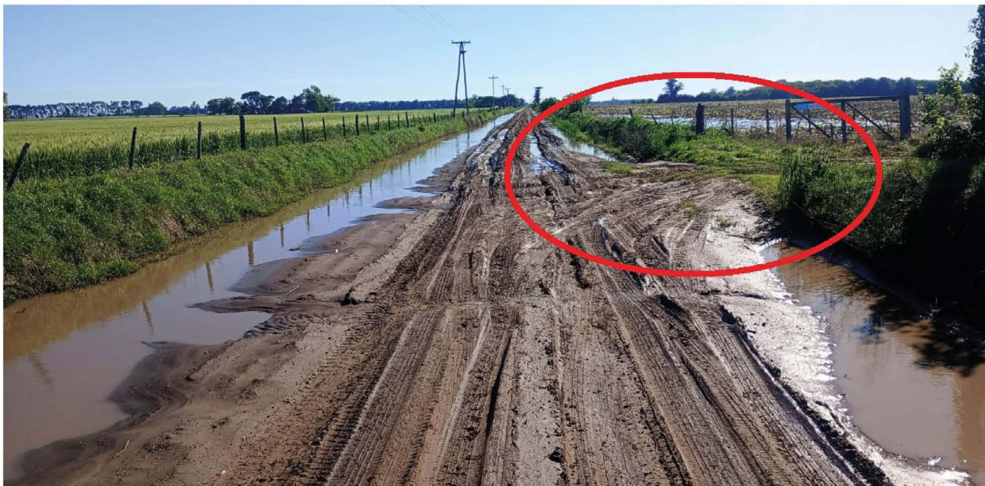
El agua se frena por la falta de alcantarillado.
