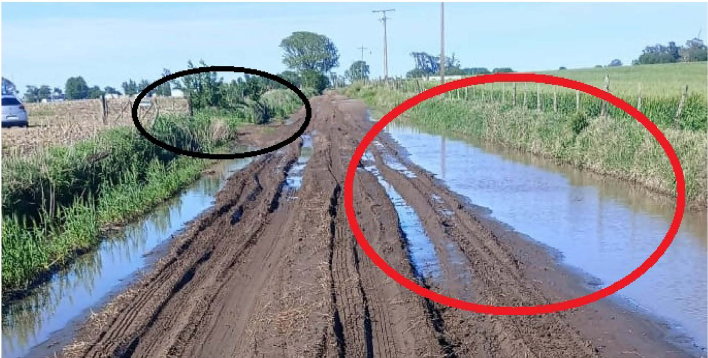
Otro acceso sin alcantarilla y los huellones profundos tras la tarea realizada días antes de las lluvias.
