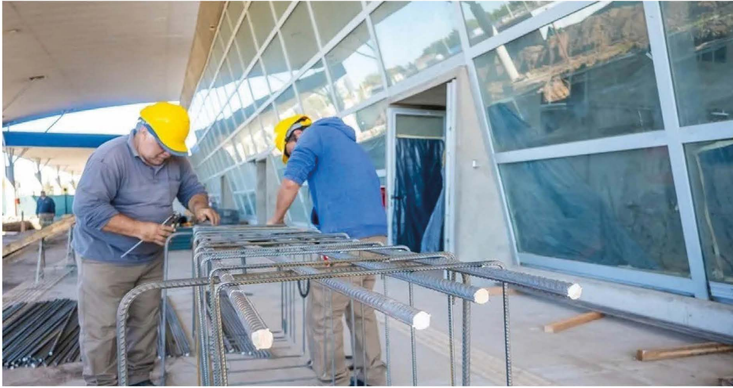
Trabajos contrarreloj para una apertura prevista para fines de julio y principio de agosto.
